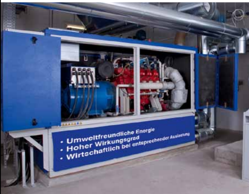
Installiertes Blockheizkraftwerk für ein Hallenbad (Quelle: bhkw-consult)
