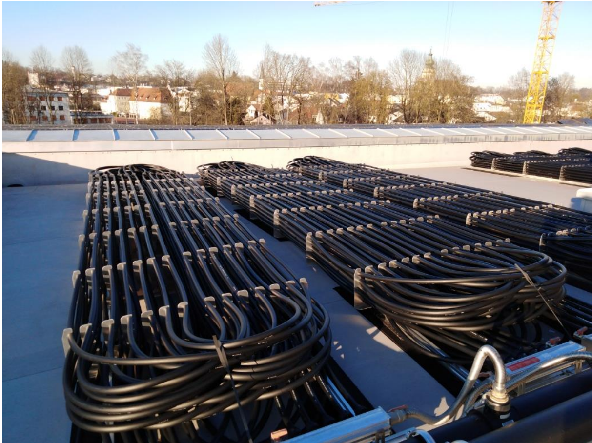
Abbildung 1: Solarkollektoren für den Betrieb eines Eisspeichers und einer Wärmepumpe; Funktion und Betriebsweise eines Eisspeichers wurden u.a. in diesem Netzwerktreffen vorgestellt.
